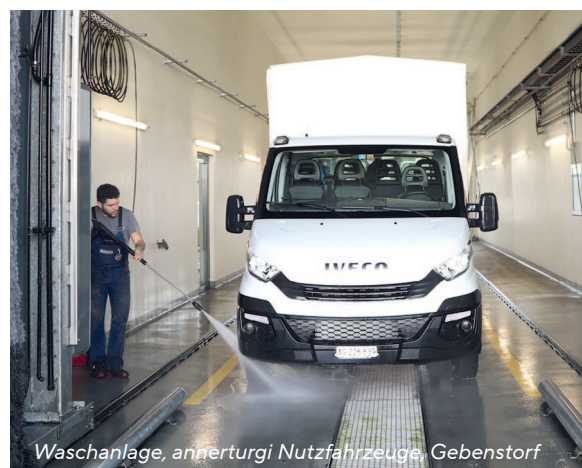
LKW-Waschanlage, ALFAG Egerkingen AG Rohrleuchten KEMI HI mit Schutzkörben
